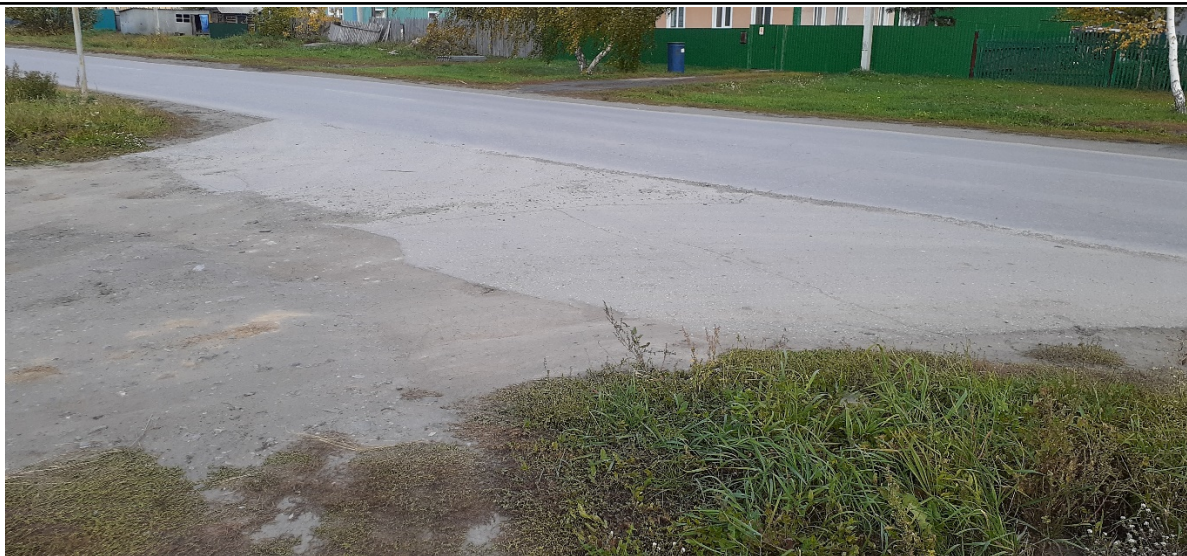
Рисунок 3 – Разрушенное асфальтобетонное покрытие на примыканиях
