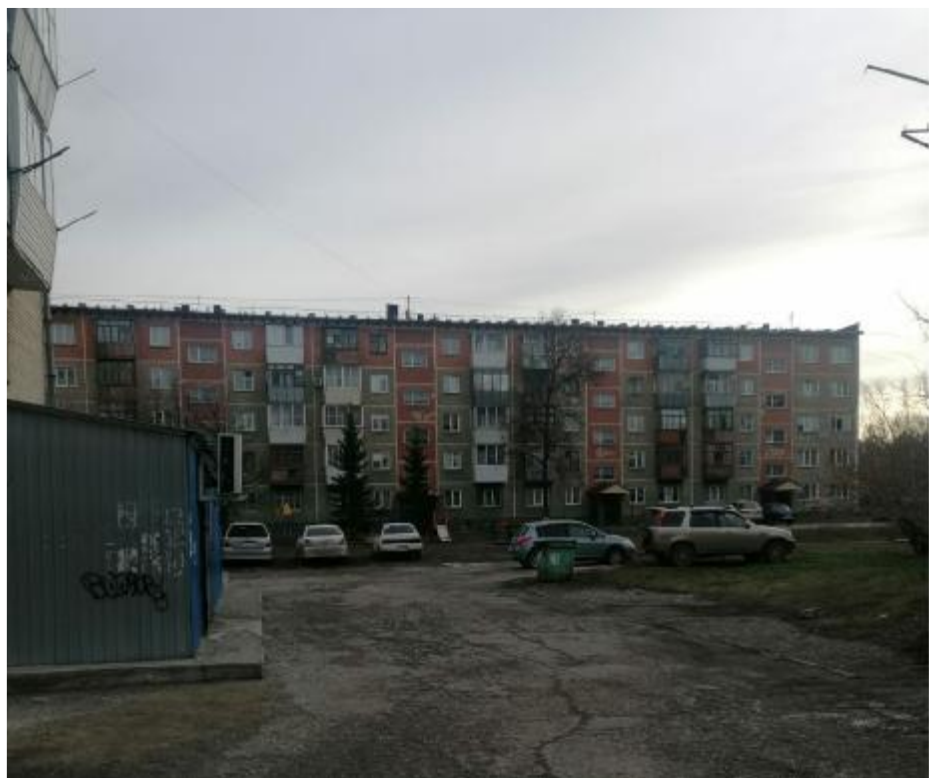
Разворотная площадка - разрушено а/б покрытие (имеются трещины, разрывы, разрушение, оголен нижний слой а/б, проседания). На данном участке из-за не правильного продольного уклона а/б покрытия, стоят лужи.
