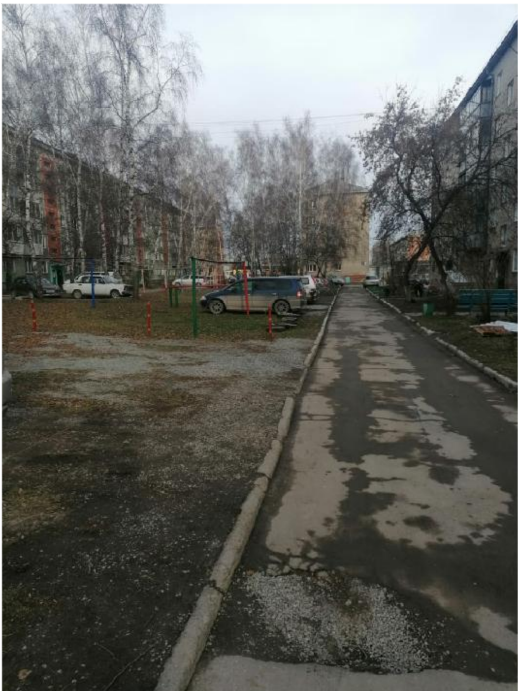
Дворовой проезд - разрушено а/б покрытие (имеется просадка, трещины, оголен нижний слой а/б,)
