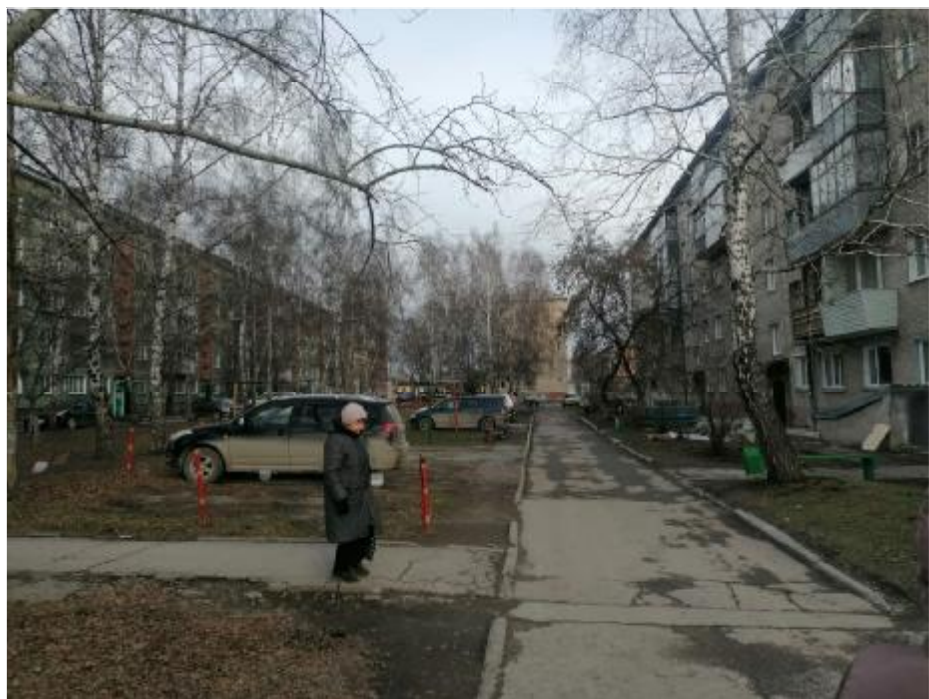
Подход к подъезду - разрушено а/б покрытие (имеются трещины, разрывы, разрушение, оголен нижний слой а/б)
