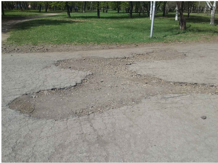
Состояние асфальтового покрытия травмоопасно
