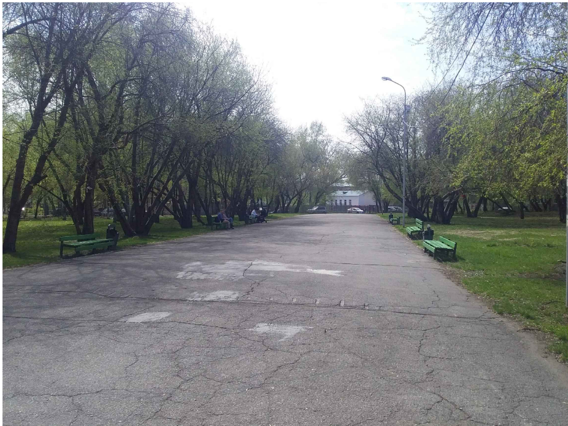
Скамьи не соответствуют современным требованиям, состояние асфальтового покрытия неудовлетворительное, частично отсутствуют бордюрные камни
