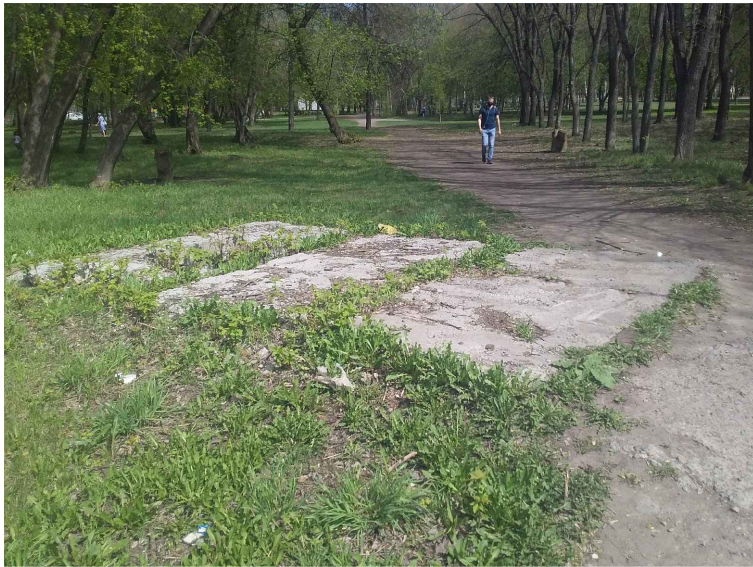
Разрушенные бетонные конструкции на путях движения пешеходов
